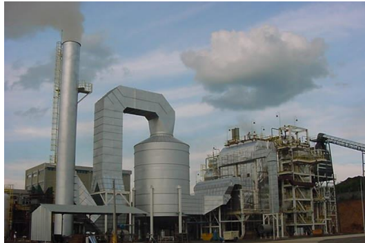
Figura 7.7. Caldera a biomasa acoplada a un separador de partículas.
