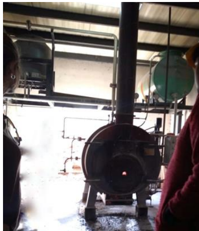
Figura 3.16. Caldera para secado de madera en el Centro Foresto Industrial Arrayanal, Jujuy, Argentina. Fuente: propia.
